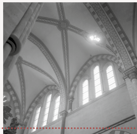
Risse im Gewölbe des Mittelschiffs, 1964. (Bild: Niedersächsisches Landesamt für Denkmalpflege, Fotosammlung)
